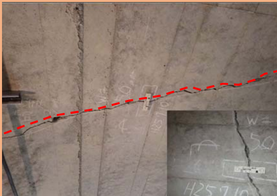
平畑トンネルのアーチ部横断方向のひび割れ(下図③)。ひび割れ測定ゲージで監視中。
