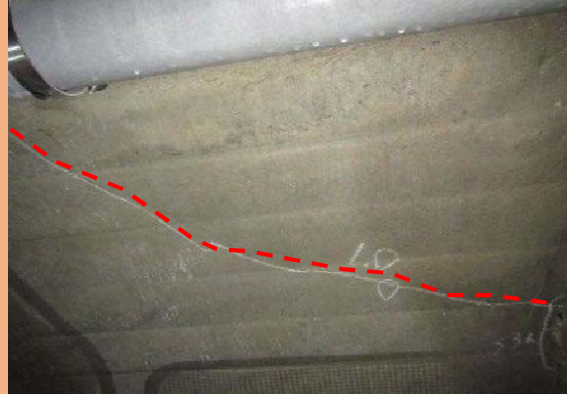
南川原トンネルの天井に発生したブロック(下図①)。はがれて落下する可能性あり。
